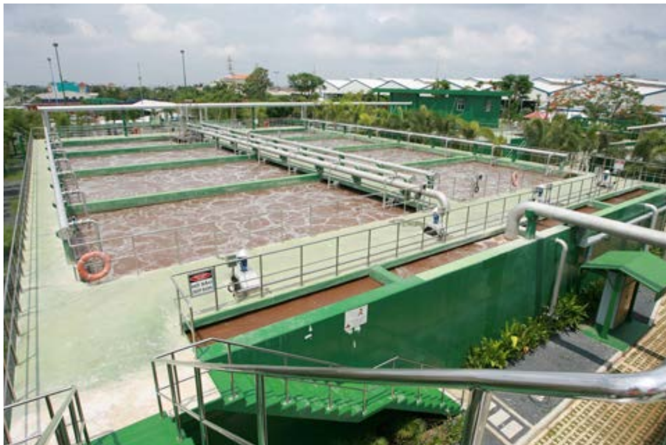
▲ Hệ thống xử lý nước thải Nhà máy giấy tại Bình Dương
